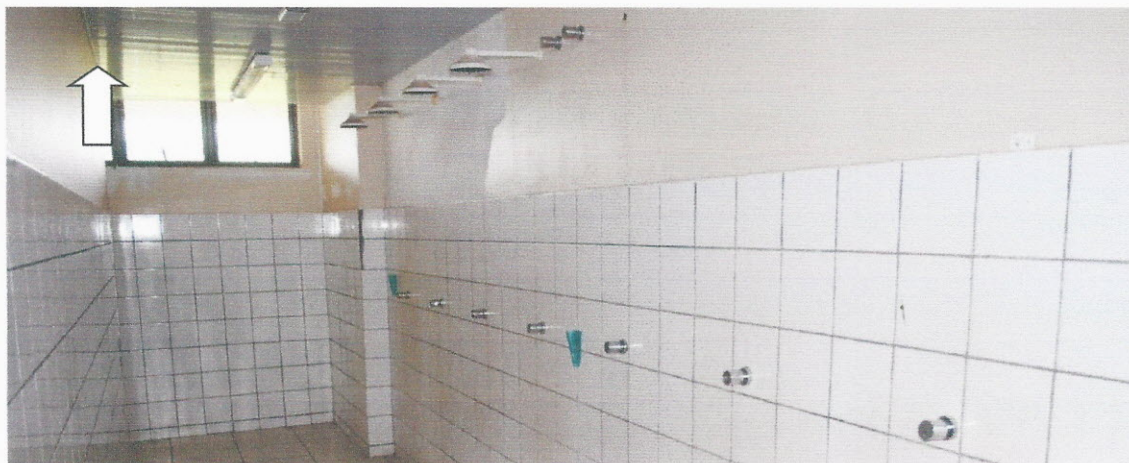
ILUSTRAÇÃO 45 – FORRO DE PVC NA ÁREA DE BANHO DOS VESTIÁRIOS
