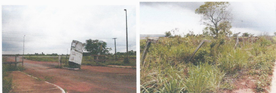
ILUSTRAÇÃO 6 – PORTÃO DE ENTRADA INUTILIZADA E ALAMBRADO AVARIADO
