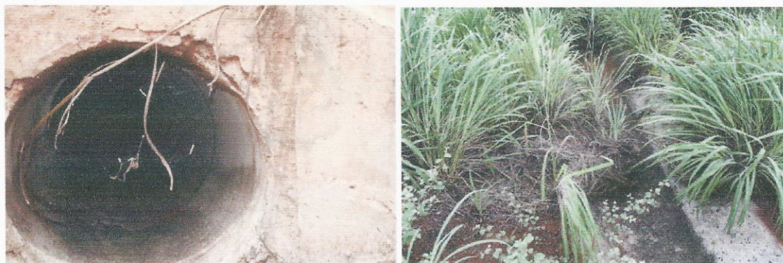
ILUSTRAÇÃO 5 – TUBULAÇÃO PLUVIAL SEM MANUTENÇÃO DE LIMPEZA
