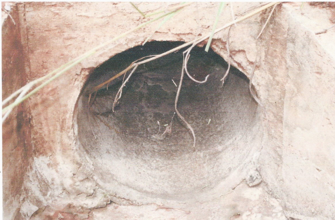
ILUSTRAÇÃO 14 – CAIXA DE CAPTAÇÃO PARA ENTRADA DE ÁGUAS PLUVIAIS. DIÂMETRO DE 60 CM
