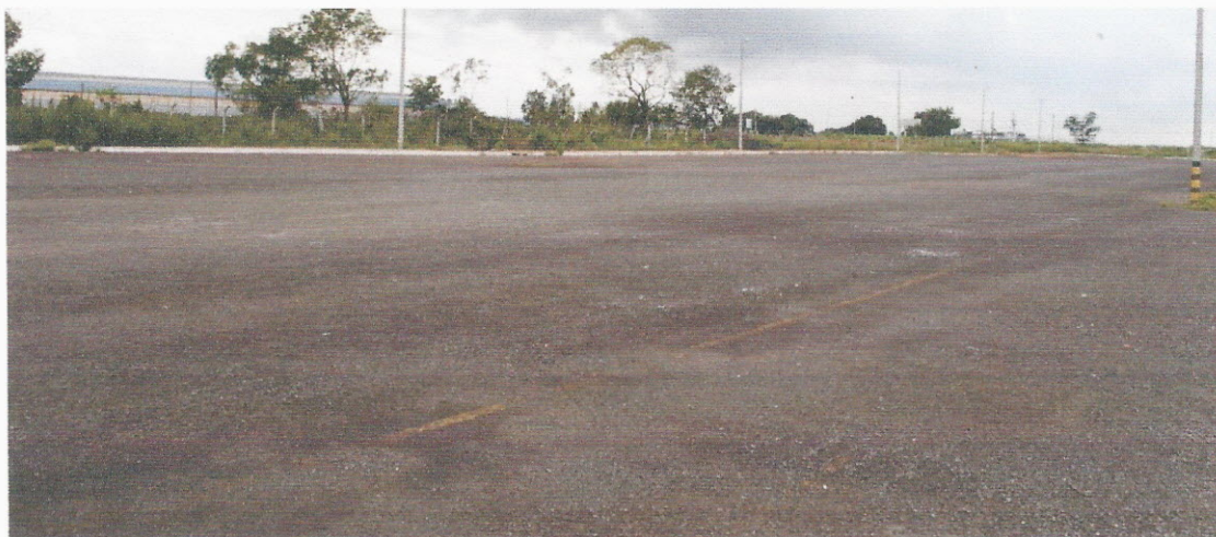
ILUSTRAÇÃO 28 – SINALIZAÇÃO HORIZONTAL BASTANTE DETERIORADA
