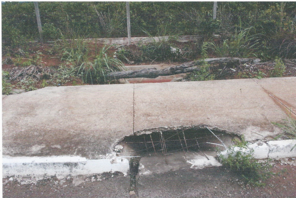
ILUSTRAÇÃO 4 – BOCA DE LOBO DANIFICADA E COM OBSTRUÇÃO
