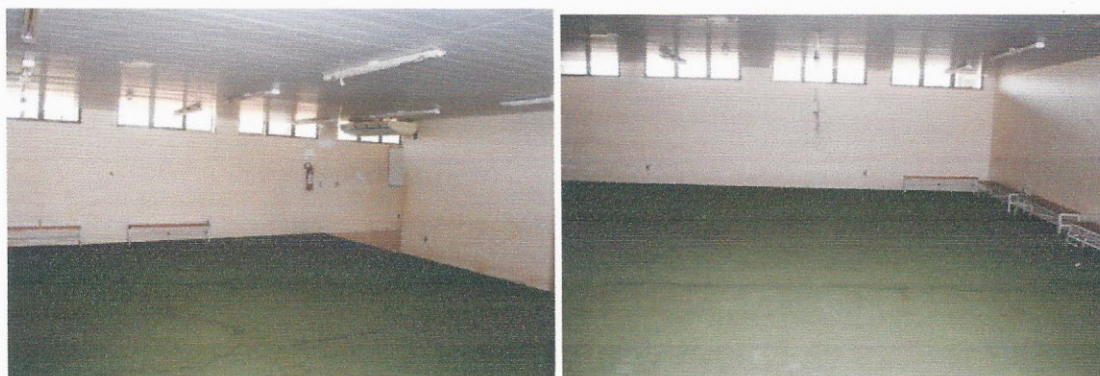
ILUSTRAÇÃO 8 – INTERIOR DOS VESTIÁRIOS (MÁ CONSERVAÇÃO)
